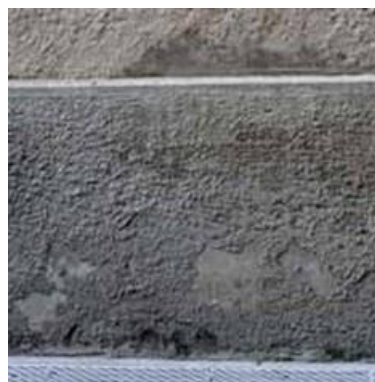
Zoccolo in intonaco a sbriccio
